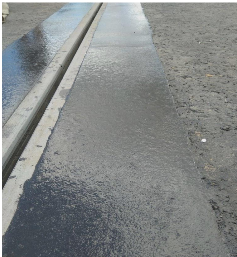
Система WETISOL-El-Stone шириной 300 мм и толщиной 45 мм устроенная в переходной зоне деформационного шва на путепроводе
